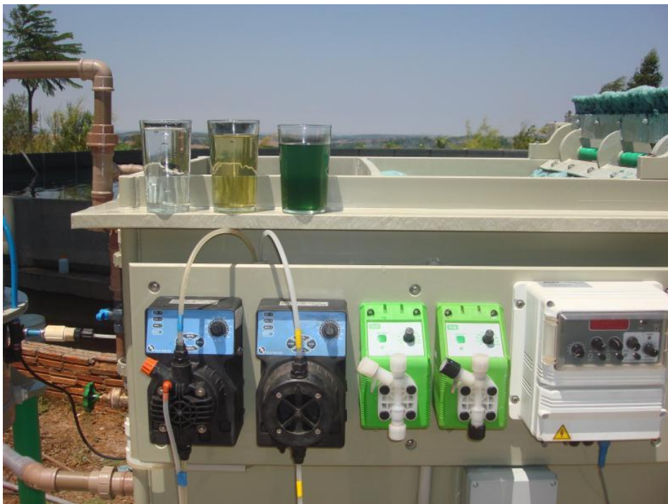
Tratamento Químico de Torres e Chillers
